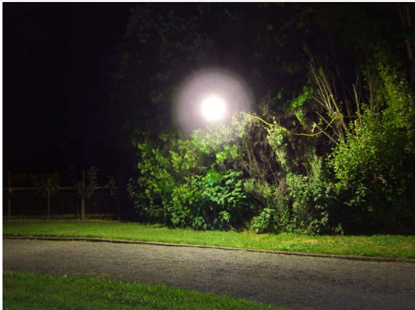
New luminaire (96w)
